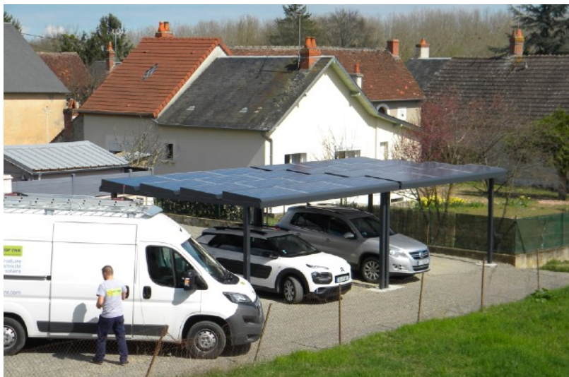
Ombrière photovoltaïque à Saint-Georges-sur-Arnon (Indre)
