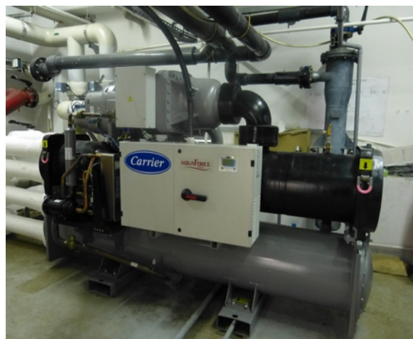
Pompe à chaleur installée fin 2012
