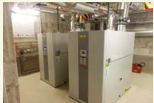
Chaufferie PAC géothermique sur nappe
