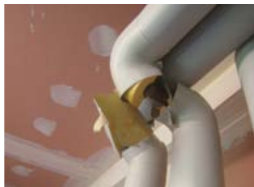
Dégradation du calorifuge sur les réseaux
