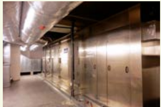
CIRMA - Centrale de Traitement d'Air
