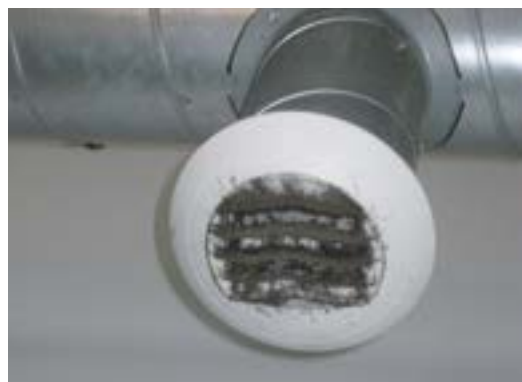
Etat d'encrassement d'une bouche de ventilation
