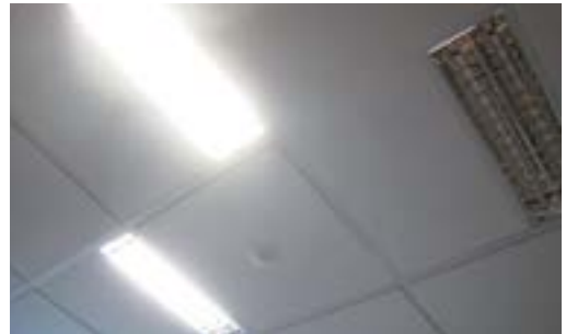
Déconnexion de tubes fluorescents pour réduire le niveau d'intensité de l'éclairage artificiel
