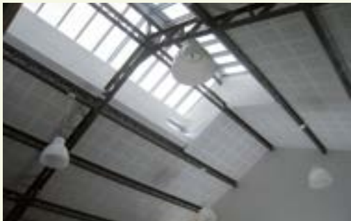
Conservation de la verrière dans un bâtiment de bureaux à Saint-Etienne (Atelier d'Architecture RIVAT)
