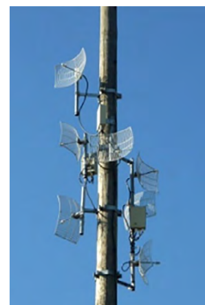
Exemple d'antennes Wi-Fi
