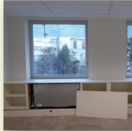
UtCi 4en1 sur boucle d'eau dans l'immeuble de la Banque de France (Paris)
