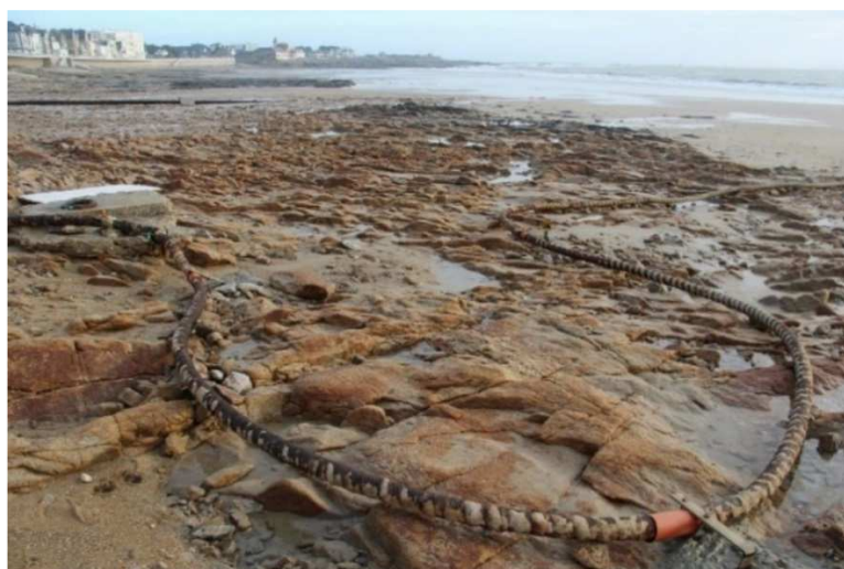
Câble électrique découvert à la suite des tempêtes de 2014 à Quiberon (Source des photos : Région Bretagne)
