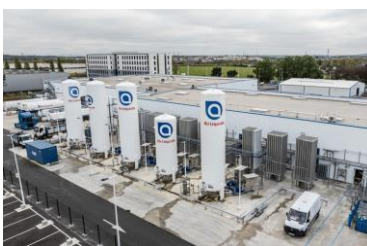
AIR LIQUIDE Usine de conditionnement des bouteilles de gaz industriels
