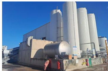
PROVENCE ENROBES Usine d'enrobés
