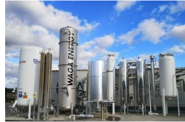
WAGA ENERGY Usine de traitement des gaz des décharges
