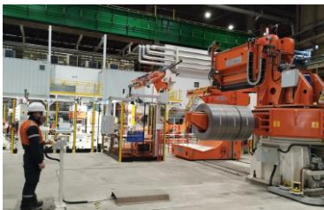
ARCELOR MITTAL Lignes d'aciers pour des moteurs électriques
